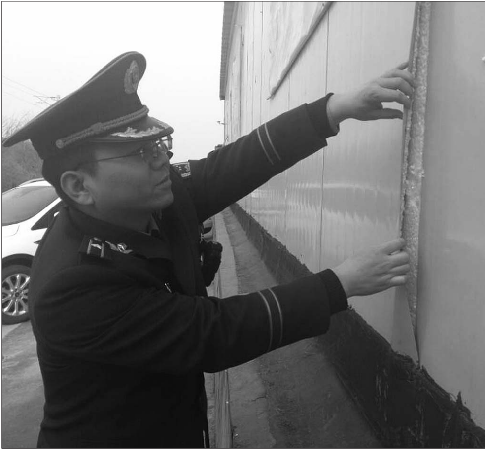
消防监督人员发现洗浴中心使用泡沫彩钢板搭建。
