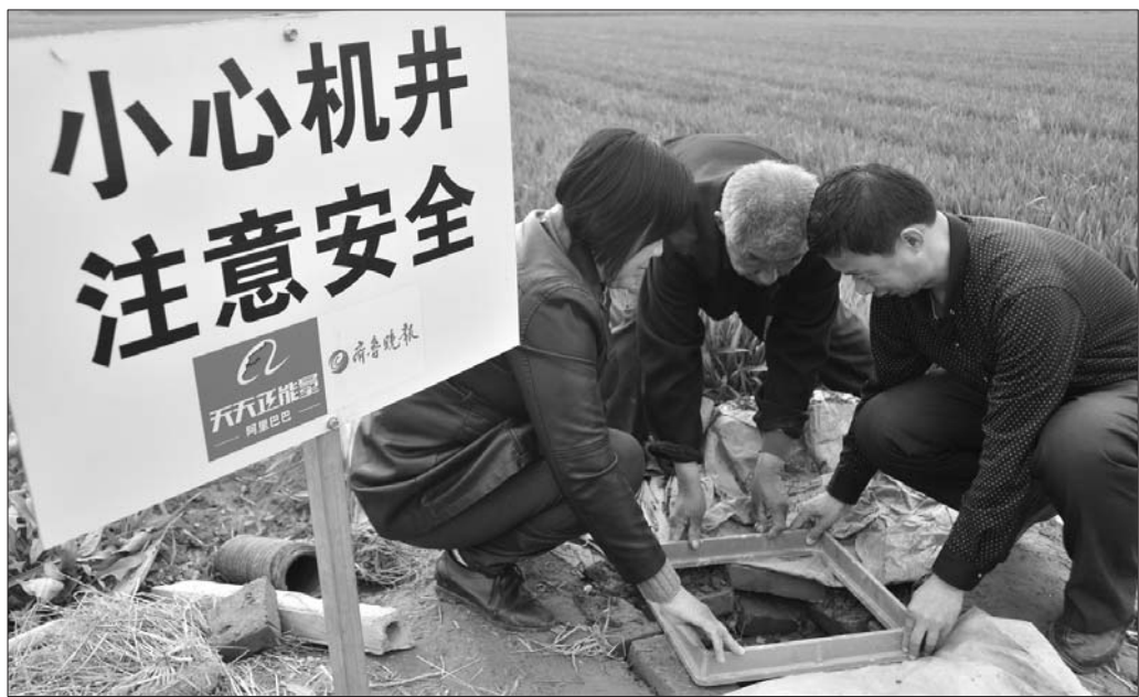
前二十里村一处隐患机井旁,工作人员同村民平整井口后将井盖底座放入井口。 本报记者 李怀磊 摄
