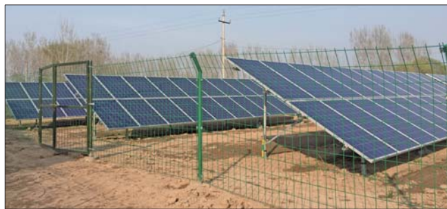
闫家村光伏发电项目。济北街道 提供
