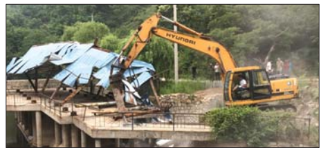
边伴随挖掘机轰鸣,小药乡违法建设被拆除。本报记者 薛瑞 摄
