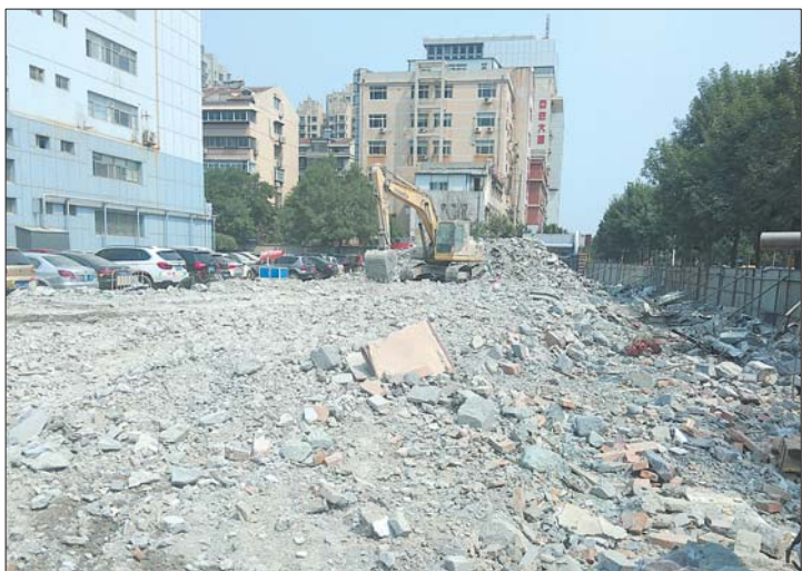
此前华龙路凯贝特大厦前遗留的拆违垃圾。
