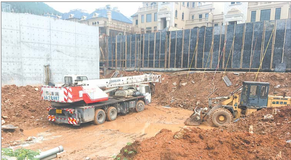
业主违法开挖的大坑大部分已经回填。
