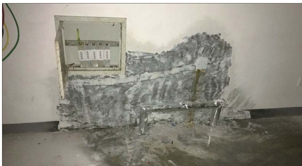
业主反映的墙面渗水、电线裸露等问题仍未解决。 本报见习记者 张晓燕 摄
