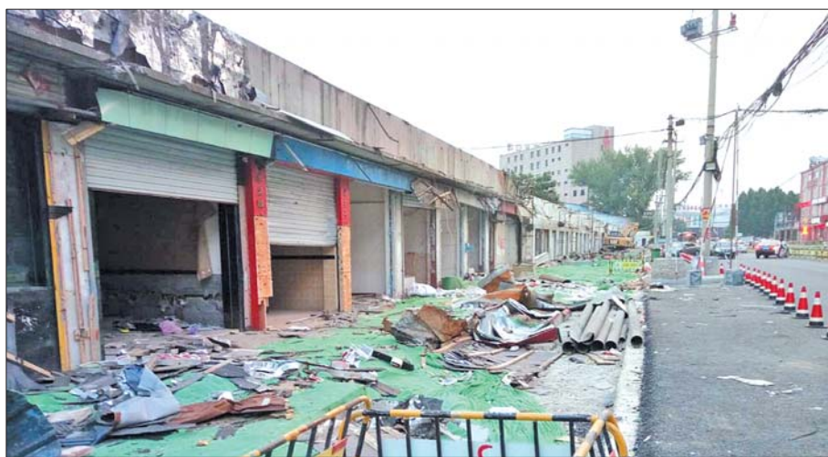
腊山北路南段北头,道路沿线影响施工的部分门头房已开拆。
