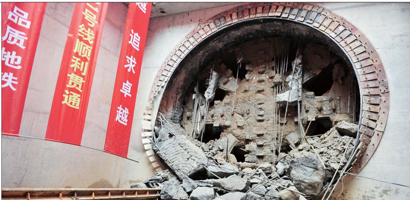
29日上午,R1线施工现场,“前进一号”盾构机在中铁十局承建的大杨庄站缓缓破土而出。 本报记者 王媛 摄
