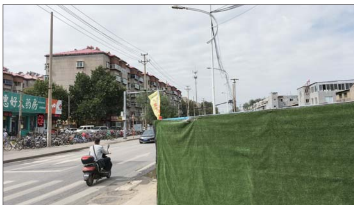
刘长山断头路沿线的机一西厂路已开始管线施工和拆迁。
