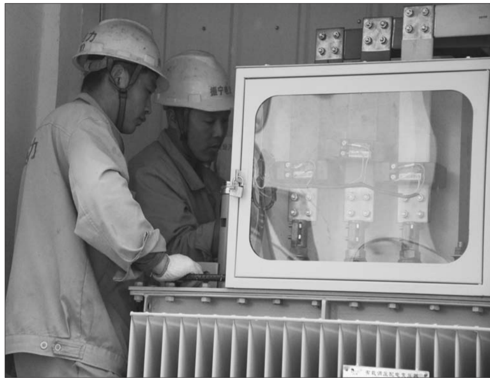
在詹邱社区内,电力施工人员正在为箱式变压器作最后的调试。
