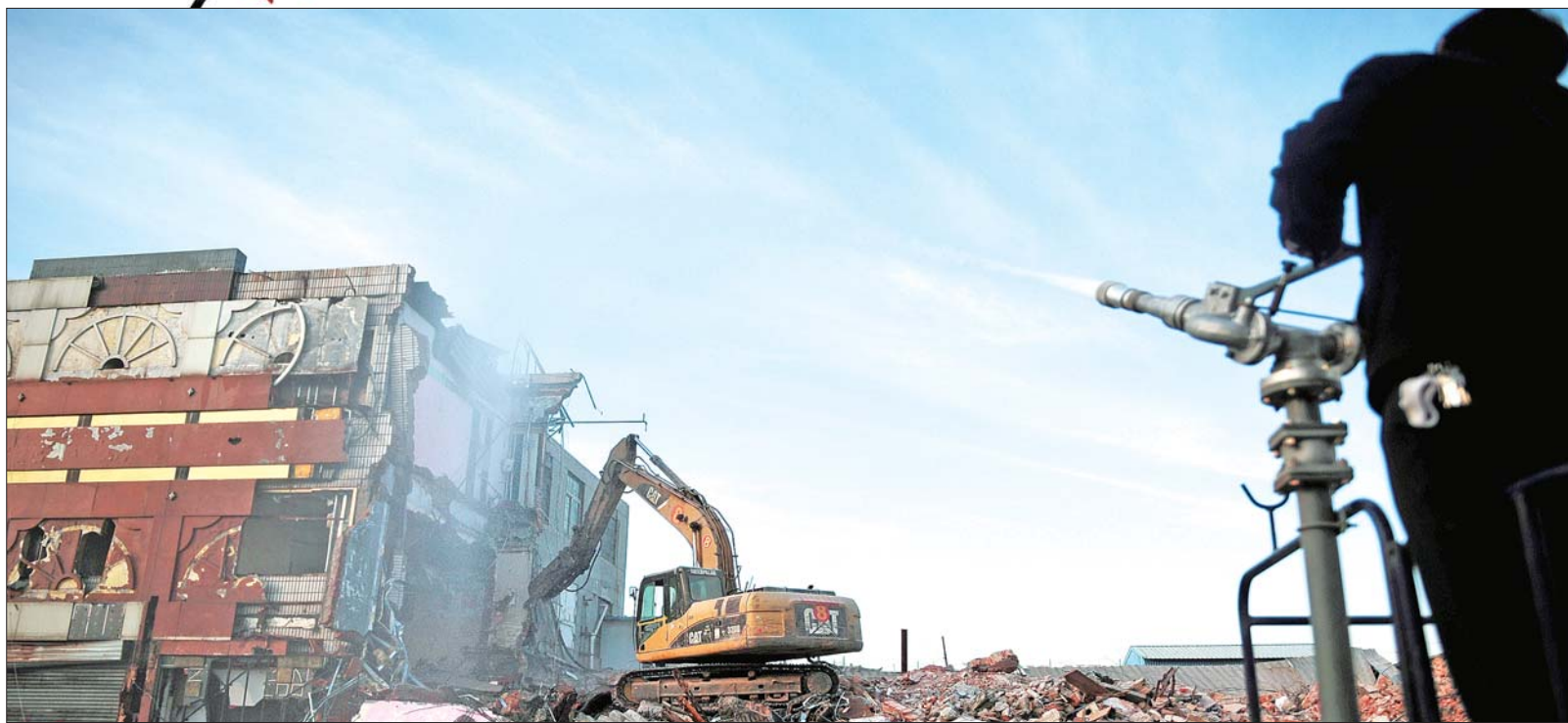
济南王舍人工业北路亮化拆迁现场,水枪在不停地喷水降尘。 本报记者 张中 摄
