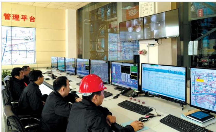
热力集团浆水泉热源厂正在对供暖情况实时监控。 本报记者 蒋龙 摄
