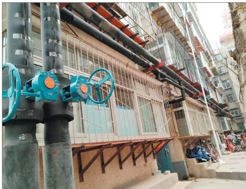
明湖小区东区的集中供暖管网已完善,本周内该小区就会热起来。
