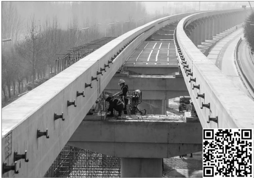
孔孟旅游快线示范线轨道梁敷设完成。本报记者 李岩松 摄
