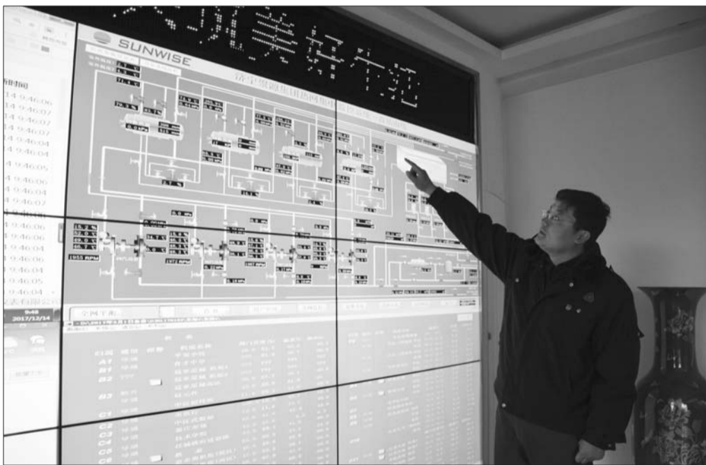
工作人员介绍供热系统的参数。本报记者 孙璇 摄
