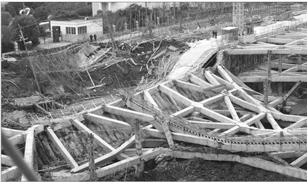
航拍南京在建工地基坑坍塌现场。据现代快报
