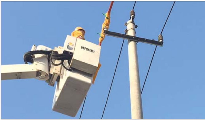
济南供电公司带电工作室工作人员在十多米高的空中带电作业,排除故障。本报记者 王皇 摄
