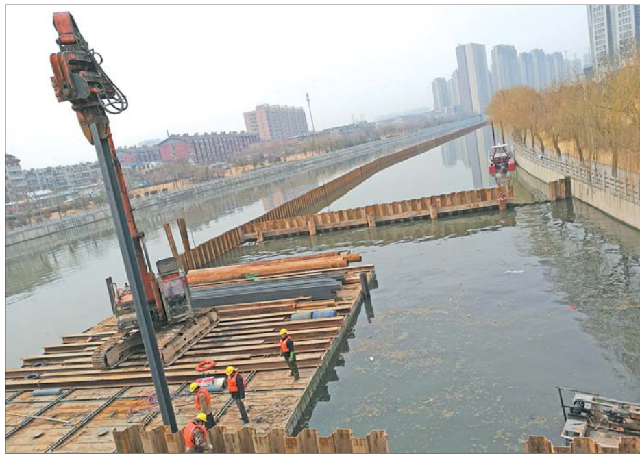
历山路北路桥附近,小清河内“清淤走廊”已搭建起来。本报见习记者 刘晓 摄
