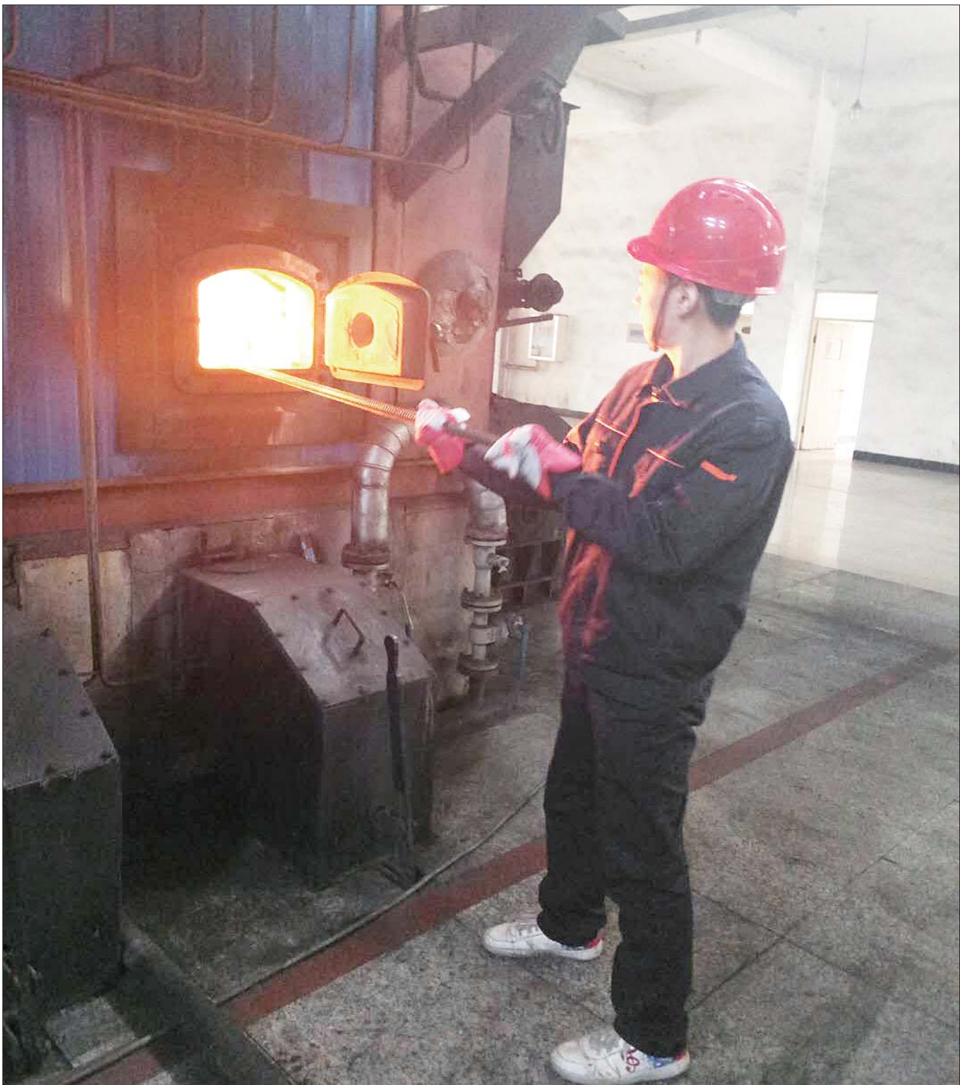
锅炉组确保锅炉供水温度。
