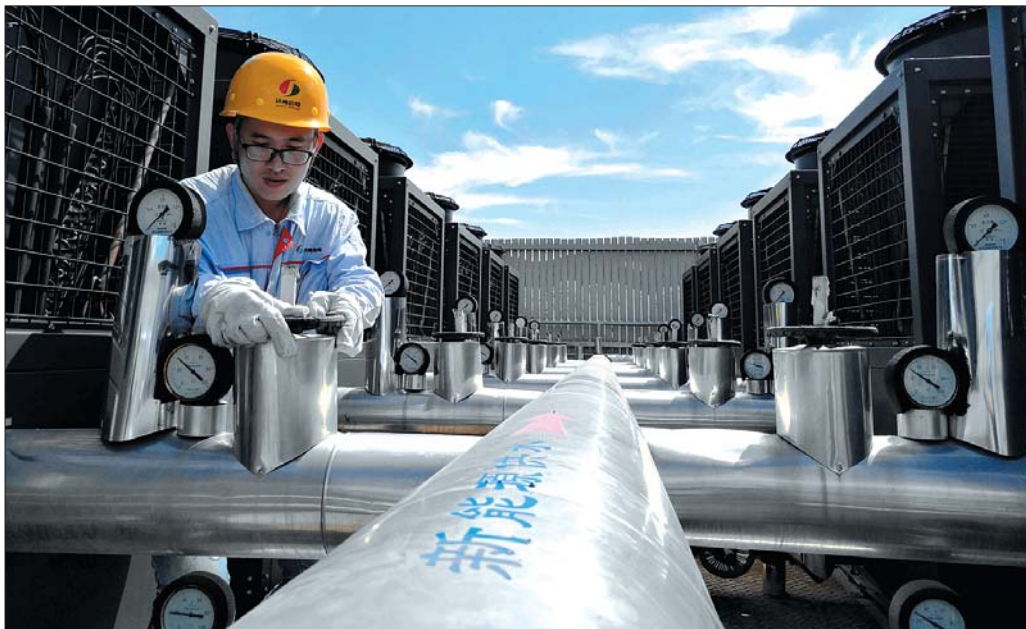
利用燃气空气源吸收式热泵供热,为小区解决了供暖难题。 见习记者 张晓燕 摄
