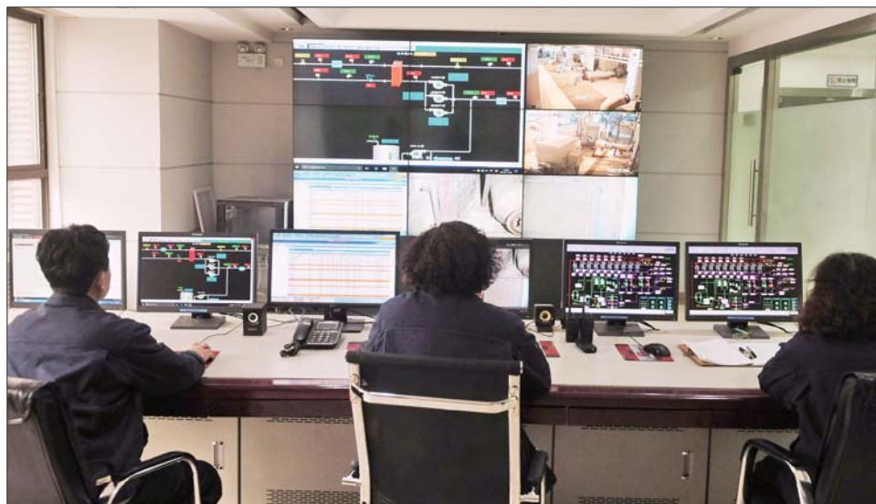
供热公司调控室,实时监控各个小区的供暖情况。(资料片)
