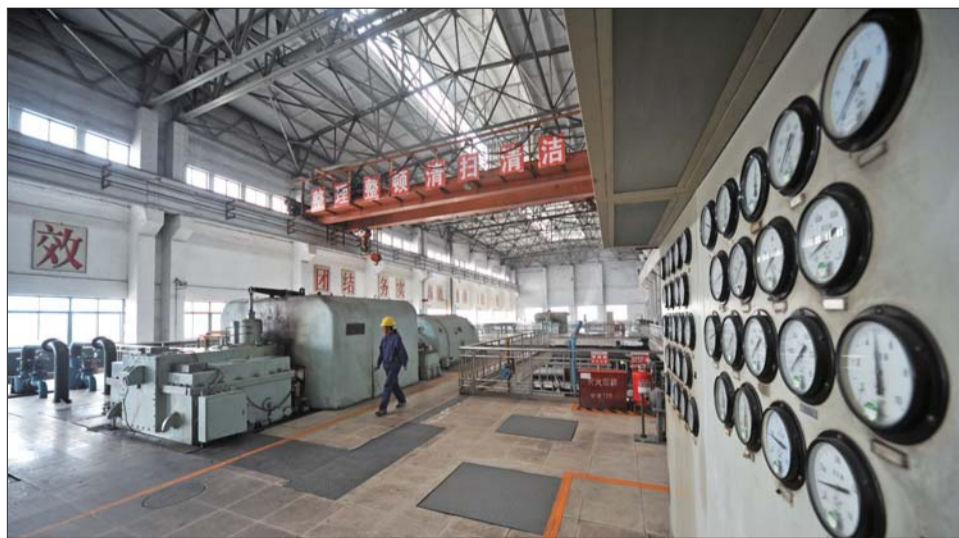
供暖工作人员巡查设备运行情况。
