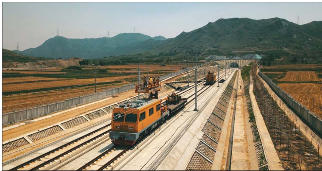
近日,中铁电气化局集团济青项目部工作人员,在济青高铁青阳隧道开始架设隧道内的第一条接触网,为济青高铁7月底竣工送电创造了重要条件。 本报记者 王瑞超 通讯员 赵萌 摄影报道
