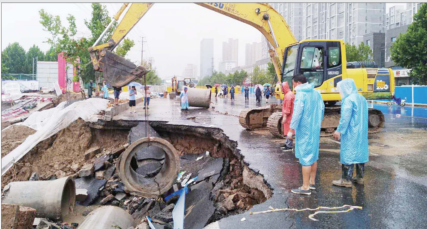
19日上午,菏泽原西关体育场某项目工地南侧沿线的中华路、北侧沿线的中和路部分路面出现塌陷,大型机械正在进行抢险工作。本报记者 李德领 摄
