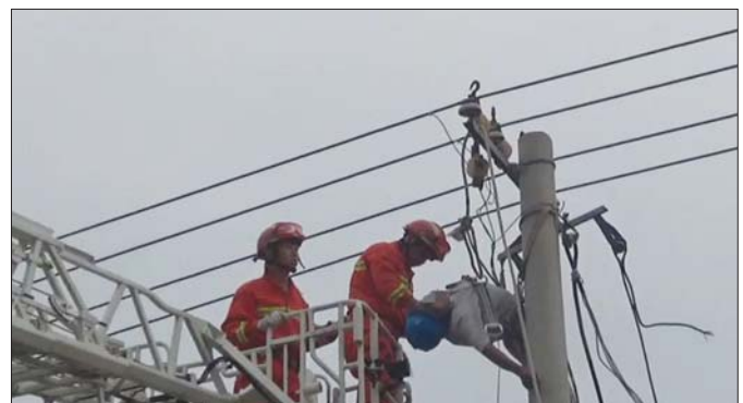
消防队员对被困工人展开施救。
