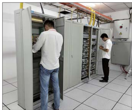
保障团队对设备进行现场检查。
