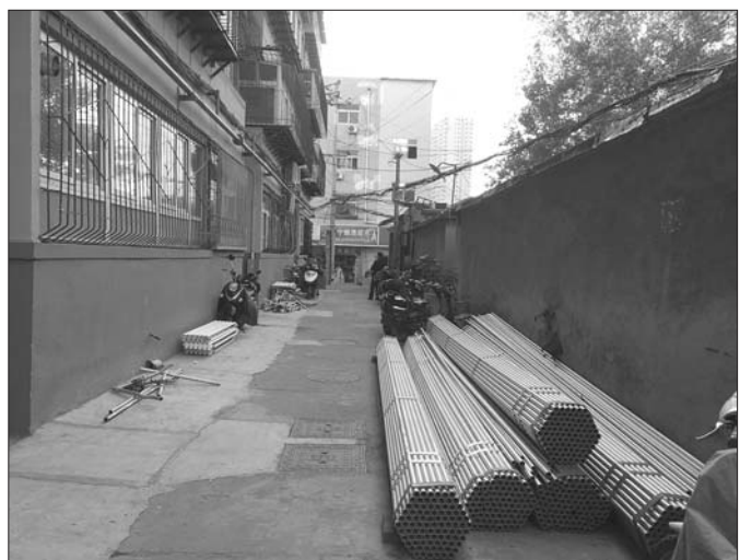
历园新村20号楼将要安装的供暖管道。
