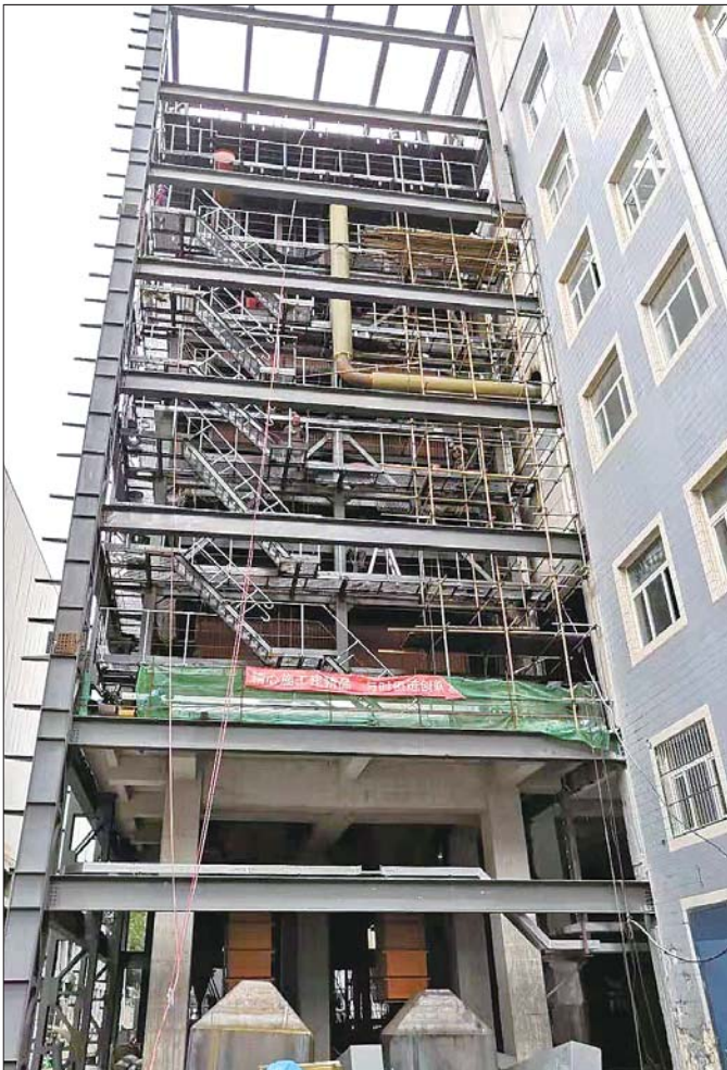
在清洁能源供暖上,浆水泉热源厂今年新建1台天然气煤粉双燃料锅炉。
