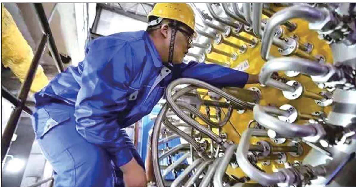
济南热电工作人员正在对燃气供热锅炉进行检查。(资料片)
