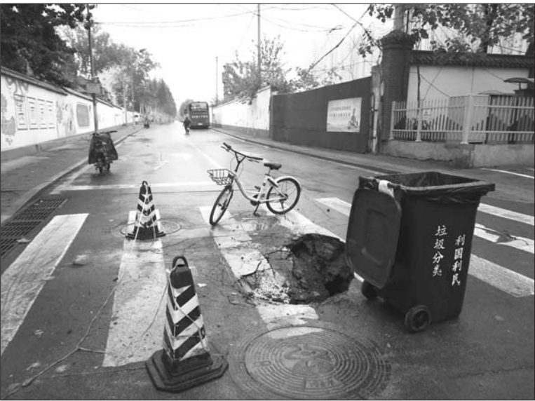
塌陷大坑周围放置了警示物,提醒过往车辆和行人。 本报记者 戚云雷 摄
