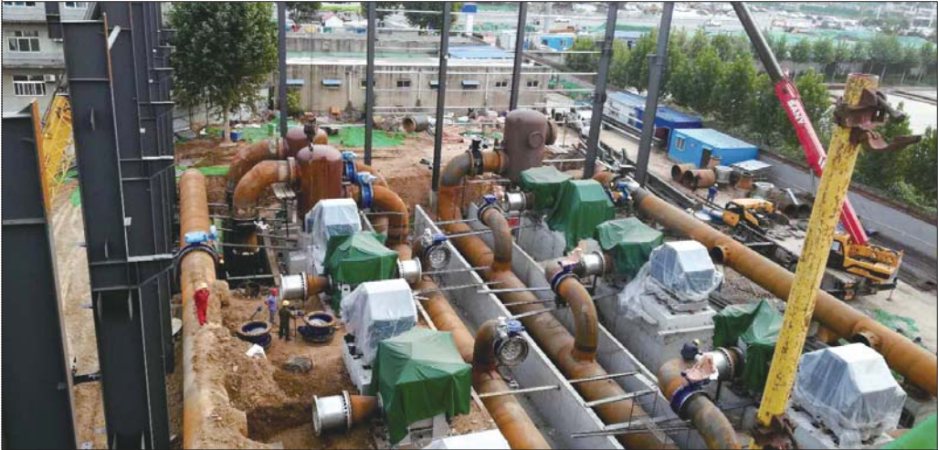
工业北路中继泵站目前已经投入使用。
