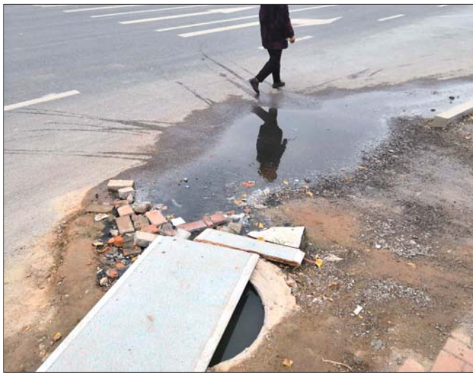
虽盖了木板,但仍未完全遮盖住井口。本报记者 赵念东 摄
