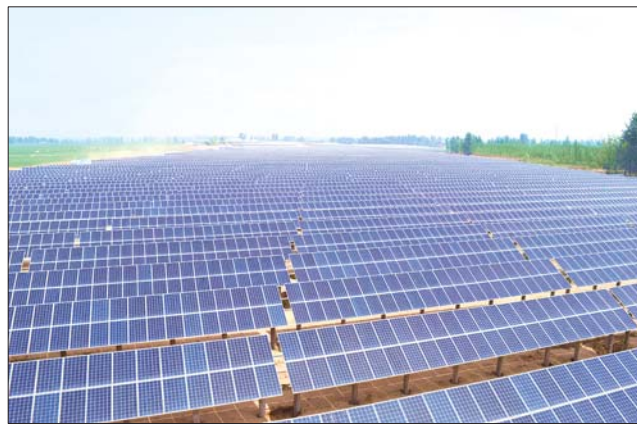
利用废弃河道建成的怀仁光伏发电项目。
