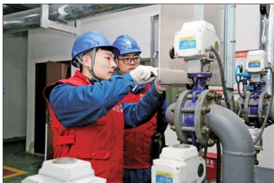
济南供电公司高压用电检人员走进辖区“电采暖”项目现场对设备进行安全体检。 通讯员 徐娜 摄
