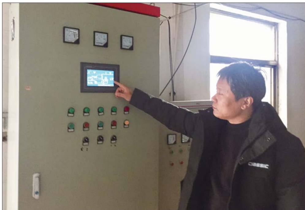
工作人员正在监控换热站实时数据。
