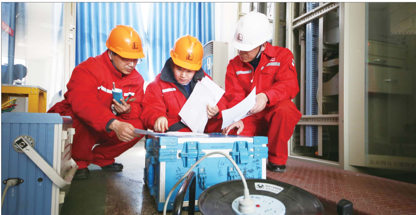
严把检修质量关,逐项测试,确保不漏项。 通讯员 颜曾 摄
