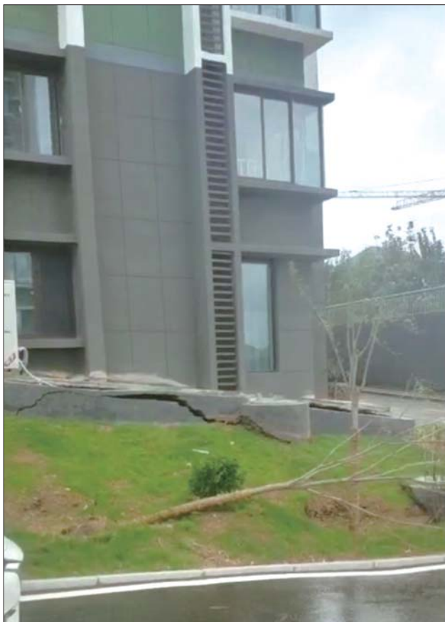
楼下外立面出现一条裂缝。齐鲁晚报·齐鲁壹点见习记者 程旭 摄
