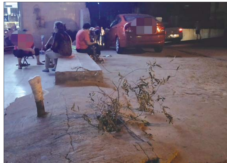
坑被居民用树枝做了“警示”。齐鲁晚报·齐鲁壹点见习记者 朱德明 摄
