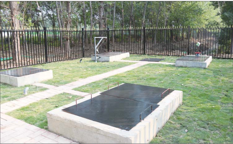
柳行新村污水处理设施。
