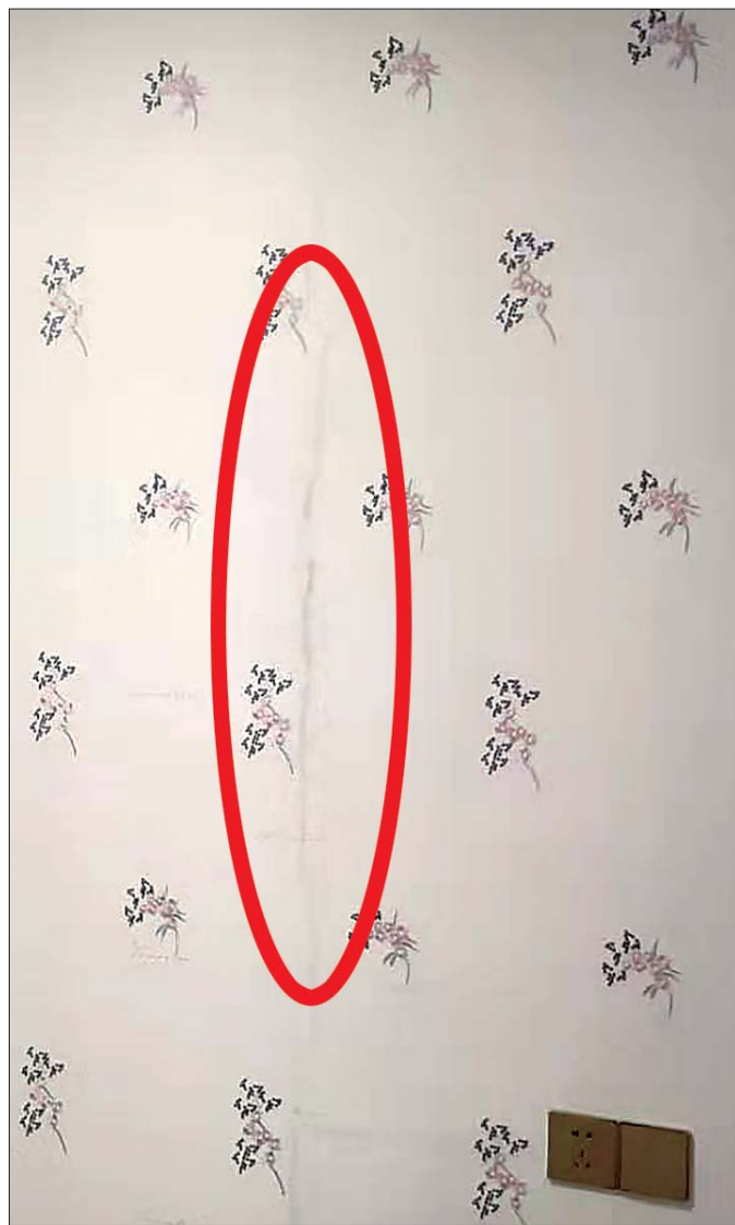
墙面有明显的裂痕。
