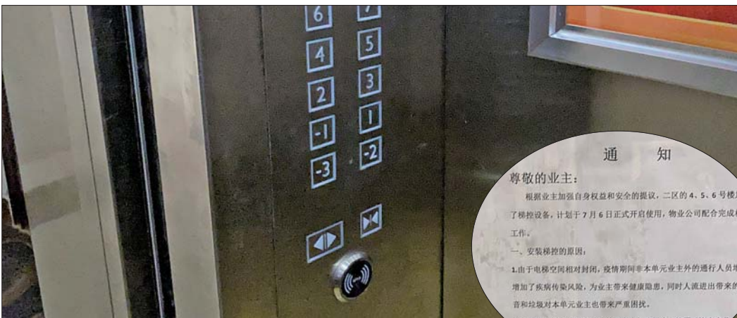
▲电梯按钮下方已经安装上一个圆形的刷卡器,这就是电梯的梯控系统。
