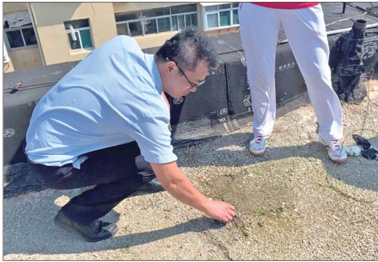
屋顶混凝土变成了砂石。
