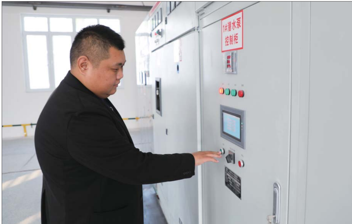
泵站内配备有先进的控制柜。
