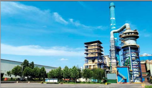
闽源钢铁脱硫脱硝设备。
