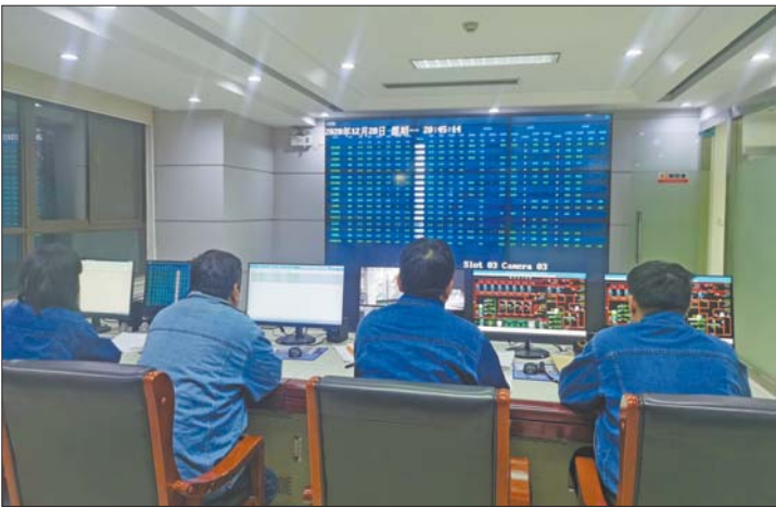
隔压站调控室,工作人员正在监控供回水压力、温度等数据。
