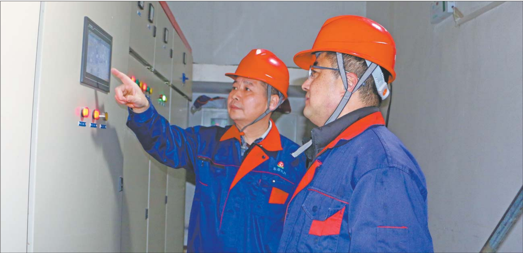
供热管家及时调整参数,保障供暖。
