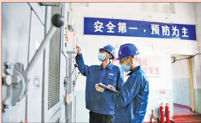
济南供电公司工作人员来到中车山东机车车辆有限公司,帮助客户检查配电室设备安全稳定运行情况。
