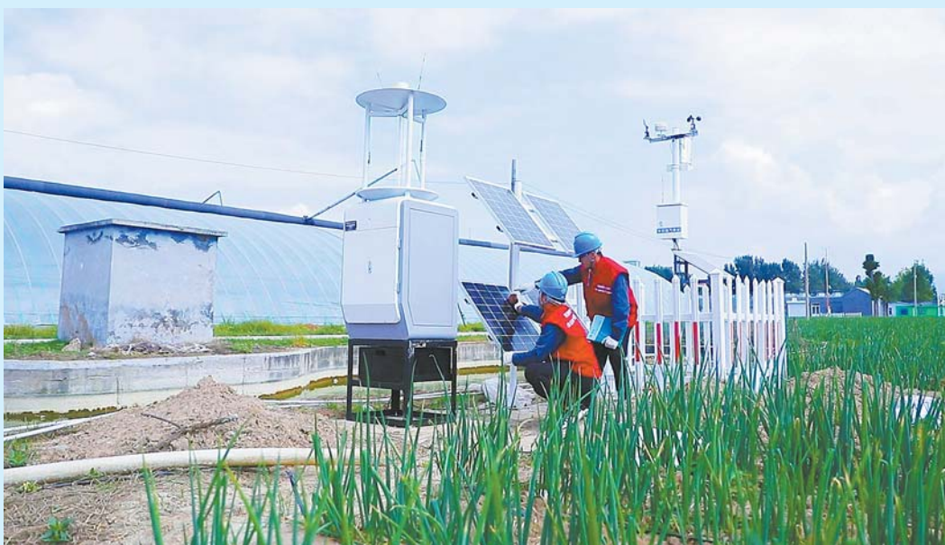
供电员工正在帮助客户检查光伏设备运行情况。
