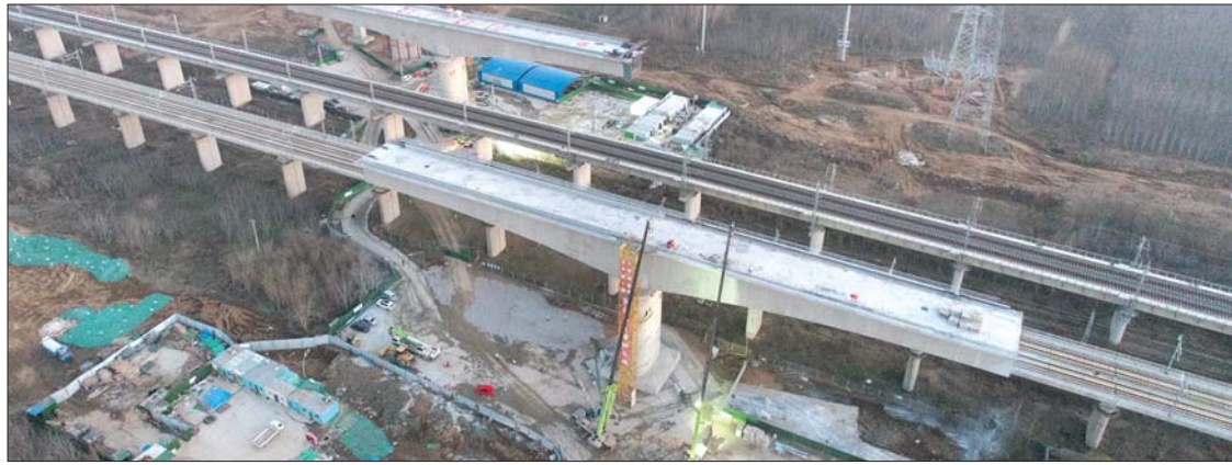
济莱高铁济南东特大桥上跨济青高铁,万吨转体桥成功转体。
