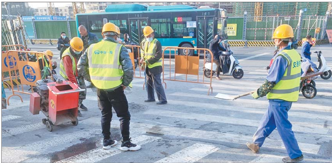
工人正在对济南地铁6号线东仓站站外的地下管线进行位置标记。
